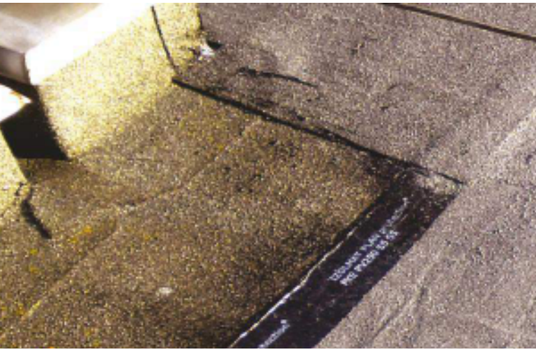
Sfałdowania na papie - zbyt długie nagrzewanie rozwijanej rolki w czasie renowacji dachu, zbyt słabe nagrzewanie podłoża.
