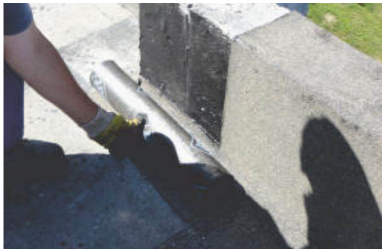
Brak zagruntowania powierzchni poziomej atyki. Gruntownie podłoża w miejscu obróbek jest szczególnie istotne.
