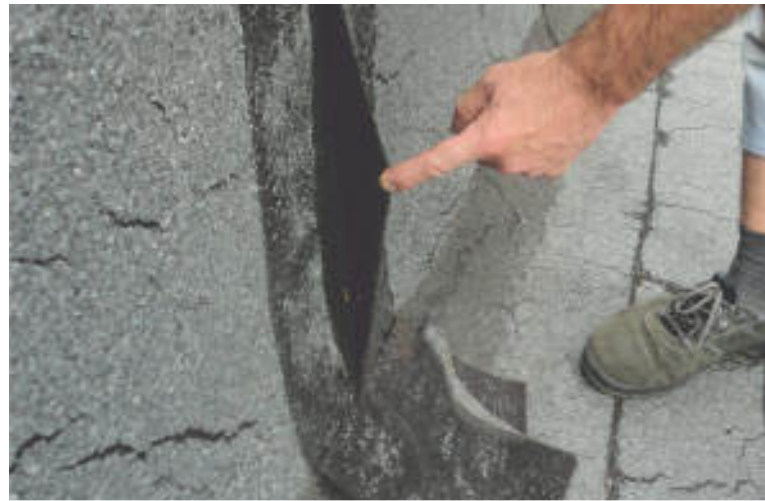
Brak mocowania mechanicznego oraz odpowiedniego nadtopienia asfaltu papy na wysokiej atyce powoduje jej rozwarstwienie.
