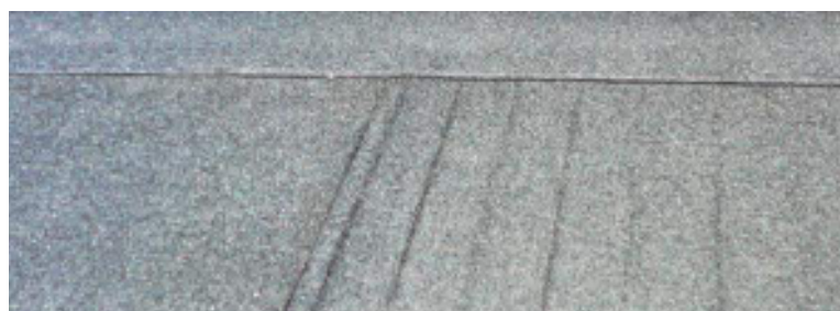
Nieprawidłowe składowanie papy w pozycji poziomej powoduje spłaszczenie rolek i powstanie nieestetycznych pasków związanych z wciśnięciem posypki w masie asfaltowej.
