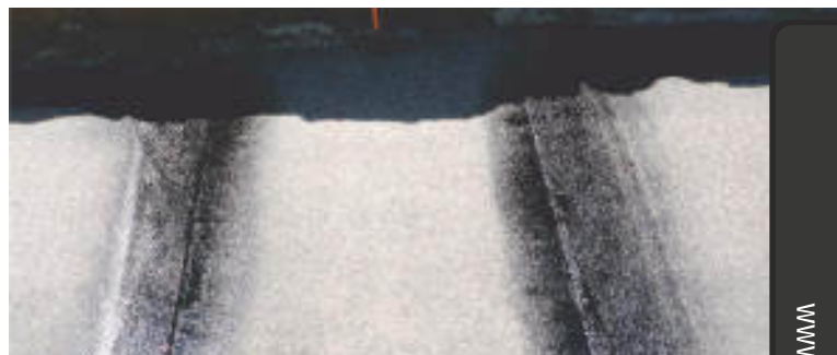
Niedopuszczalne zgrzewanie pap od góry. Nie daje żadnej pewności że styk pap jest szczelny.
